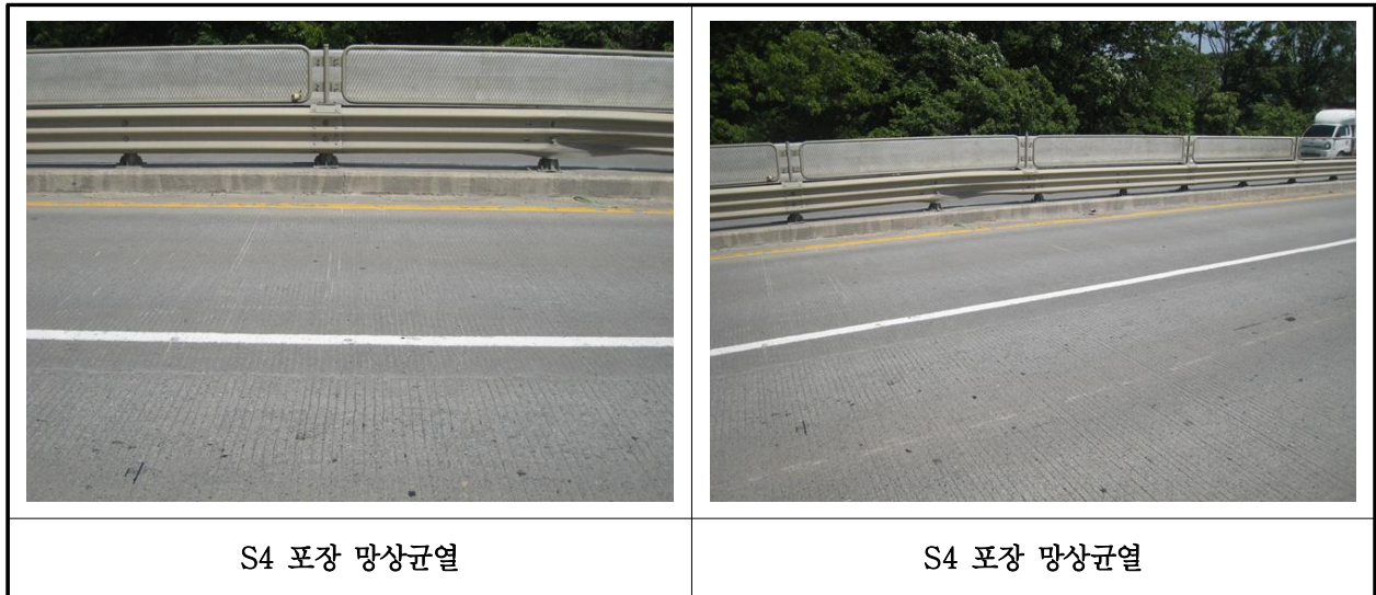
【사진 3.3.18】 교면포장 손상현황(계속)
